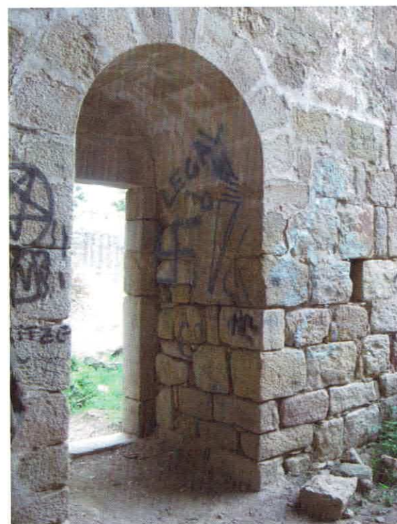
Mostres de vandalisme a Roca-rossa
